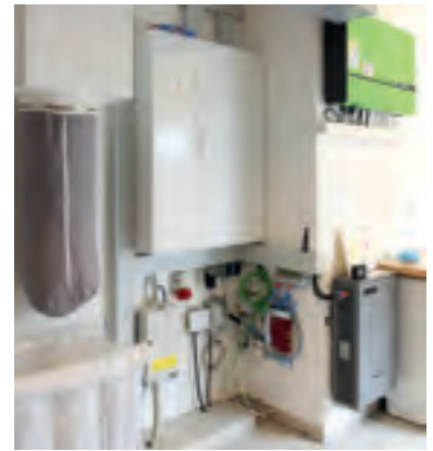
Dans le local technique du bâtiment, un onduleur avec batterie de stockage pour le système photovoltaïque est installé à côté de la goulotte à linge.
